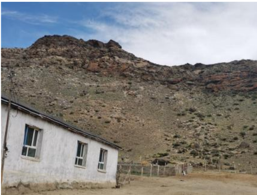
照片 3.4.2 崩塌坡面现状
